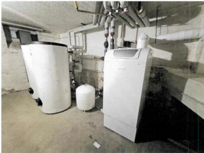
Bild 14: gemeinsamer Heizungsraum im Keller des Hauses Robert-Koch-Str. 36
