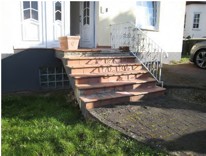
Bild Nr. 4, Außentreppe zum Gebäude mit abgeplatzten Setzstufen und Stufen.
