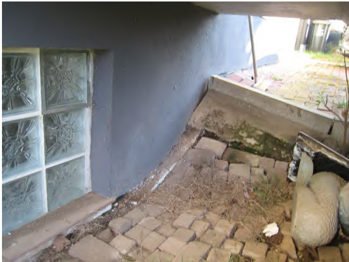
Bild Nr. 5, Setzungen unter der Treppe.
