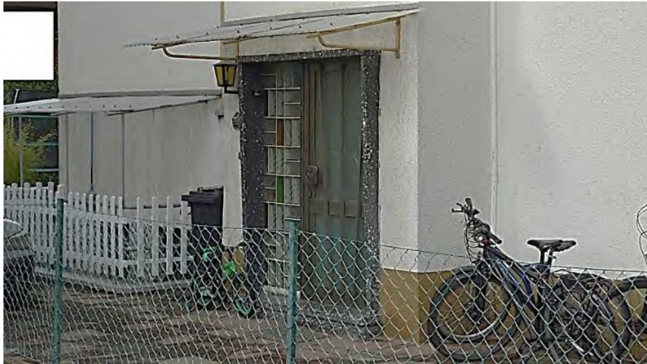
Kelleraußentreppe (überdacht) und Haustür (Glas defekt)
