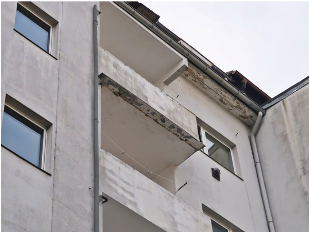
Schäden an der unterseitigen Traufbekleidung
