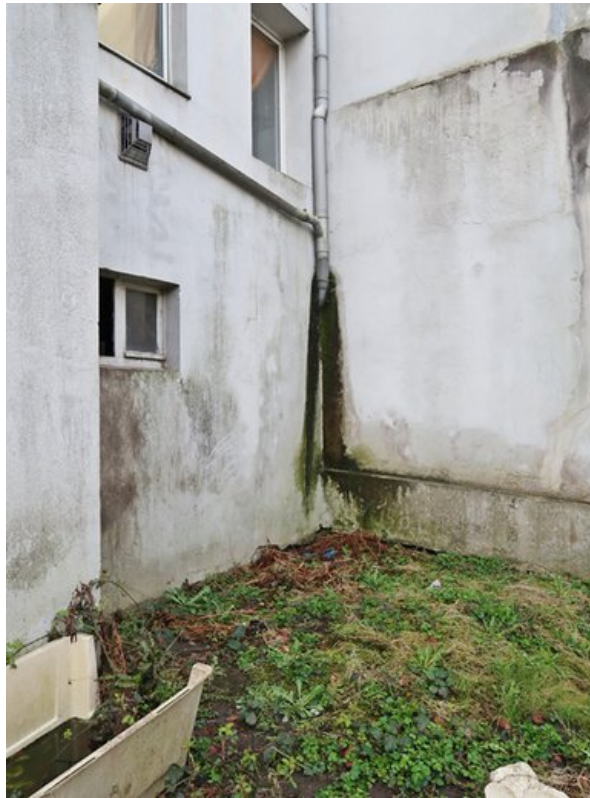
Deutliche Verfärbungen im Bereich des Fallrohres der Dachentwässerung
