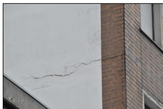
Putz-/Mauwerwerksriss Giebel Friedenstraße
