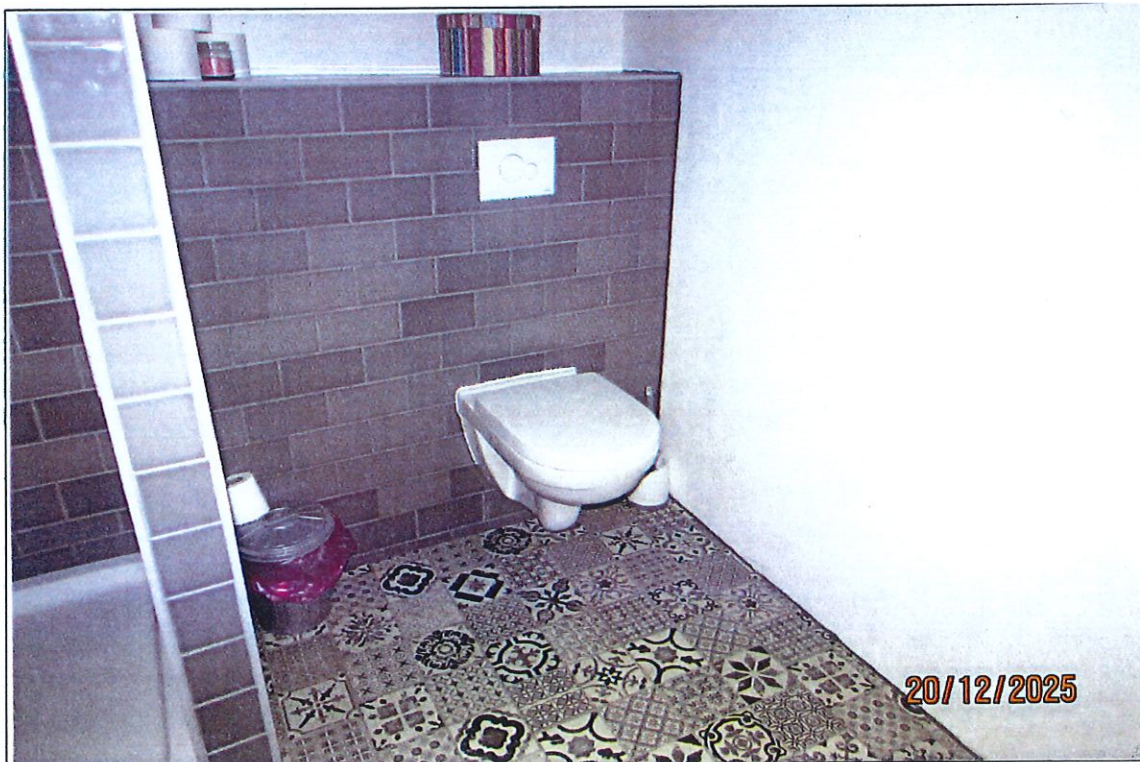
Abbildung 27: Toilette und Dusche.
