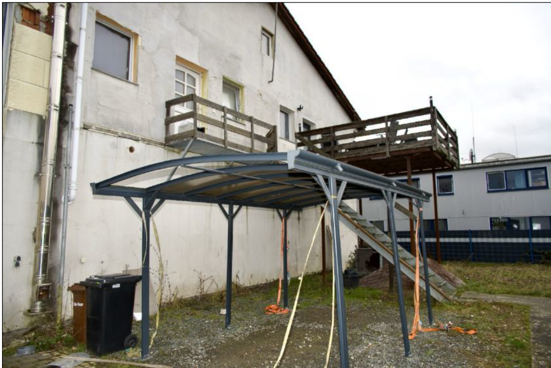
Foto 5 Lagerhalle mit Büro - Zugangstreppe zum Obergeschoss (bauordnungsrechtlich nicht zulässig)
