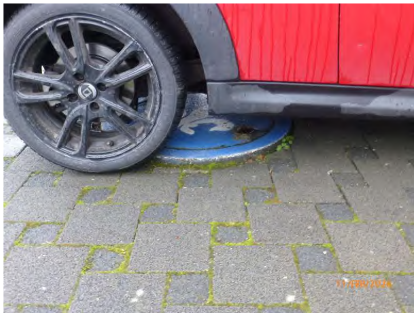
Zisterne unterirdisch im Vorgarten
