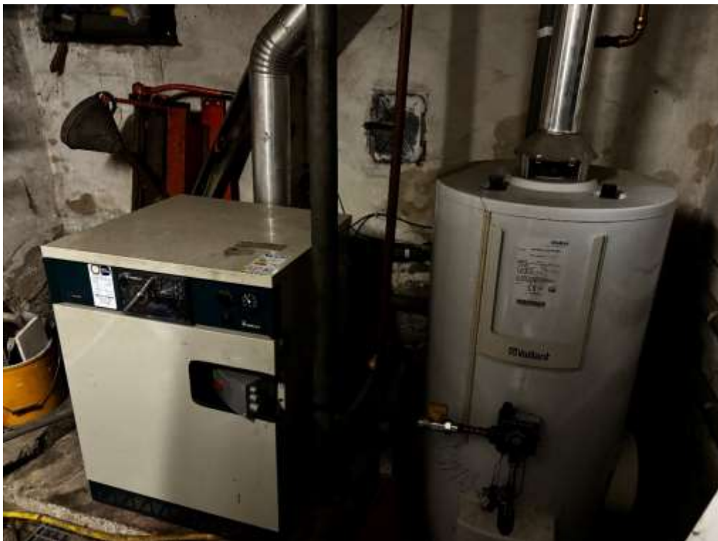
Heizungsanlage mit Wasserspeicher
