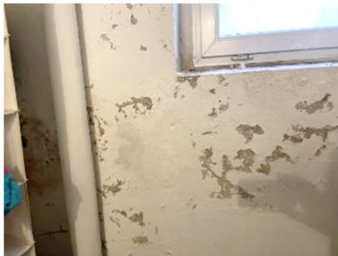
Feuchtigkeitserscheinungen im Kellergeschoss
