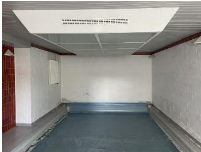
Schwimmbad, Feuchtigkeitserscheinungen an den Wänden
