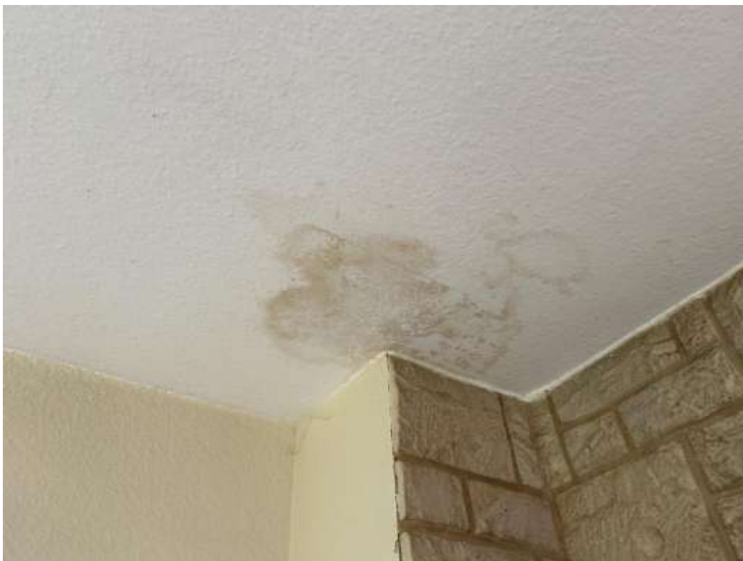
Anlage 5.13: Bild 13 Durchfeuchtung Deckenbereich im Dachgeschoss
