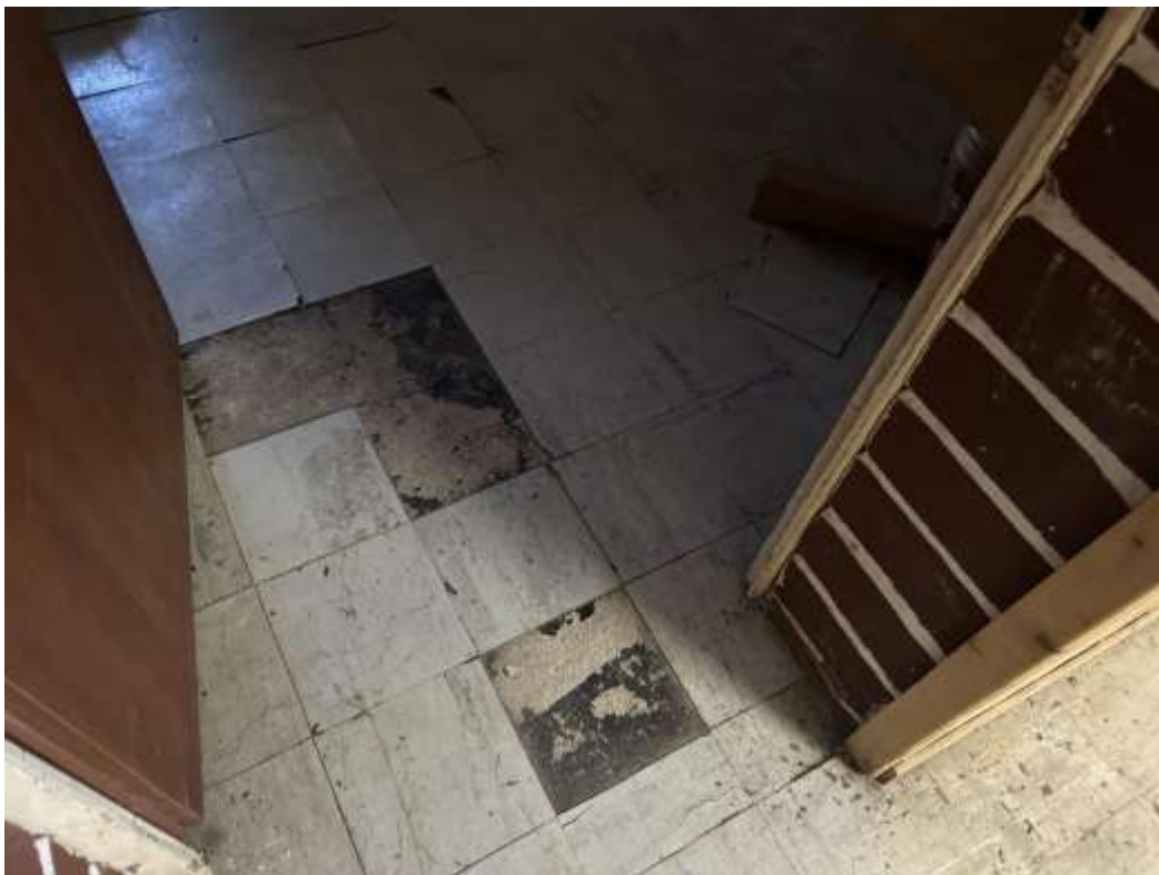
Anlage 5.16: Bild 16 Kellergeschoss, Schäden am Bodenbelag aus Flexplatten
