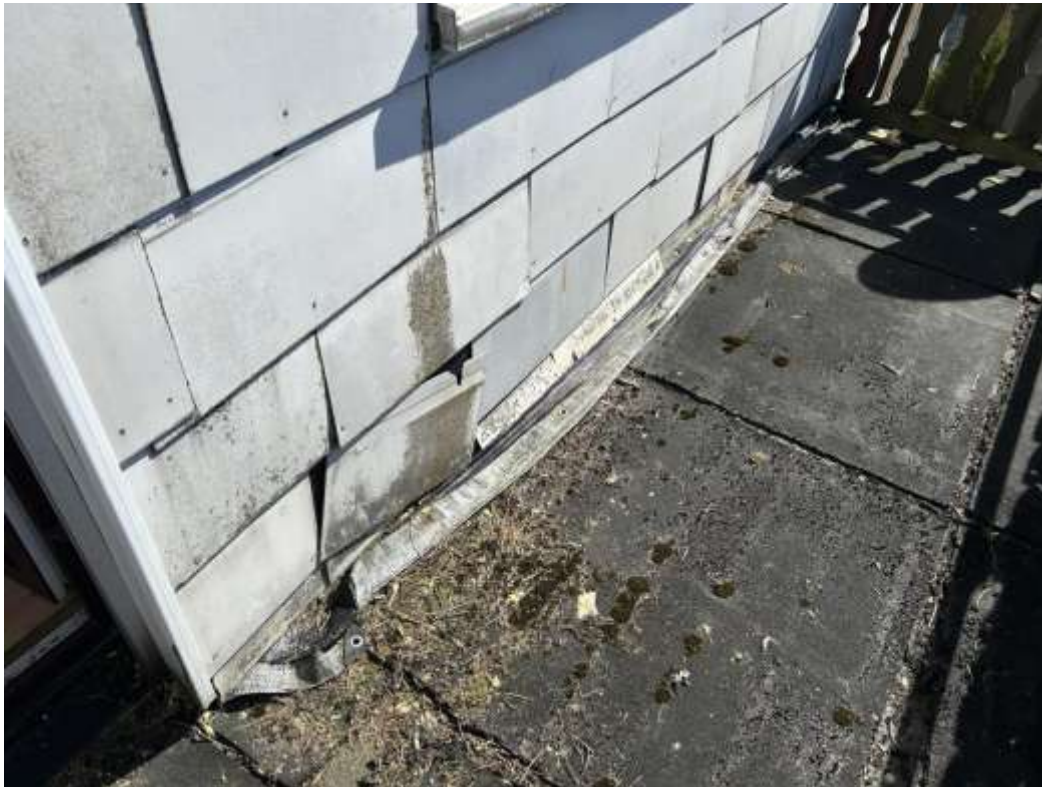
14: 14 Schäden am Behang des Giebels
