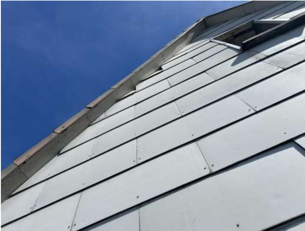
Anlage 5.15: Bild 15 Schäden am Behang des Giebels
