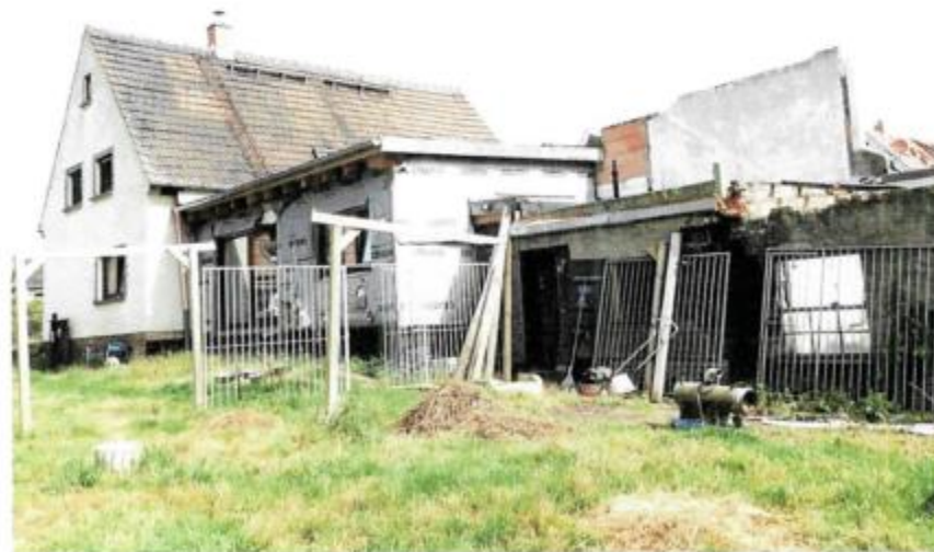
Bild 4: Ansicht der Gebäude vom Garten aus (im Bild rechts massiver Schuppen und abbruchreife Bauwerksreste)
