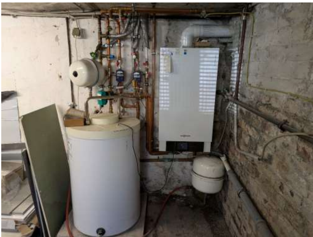
Heizung im Keller
