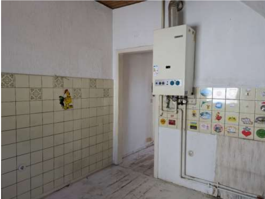
DG: Küche mit Heizung
