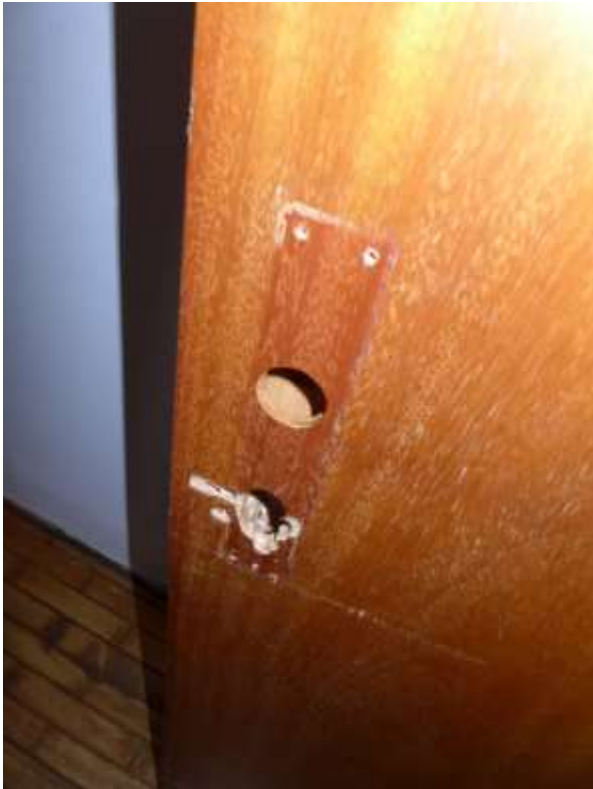
25 a schadhafte Türen Whg. Nr. 3
