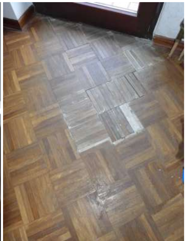
16 b schadhafter Boden
