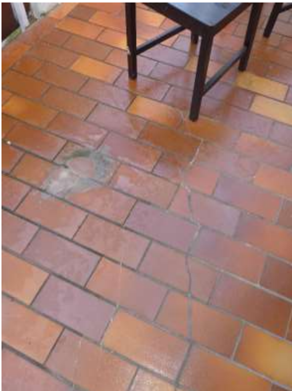
14 a schadhafte Fliesen Balkon
