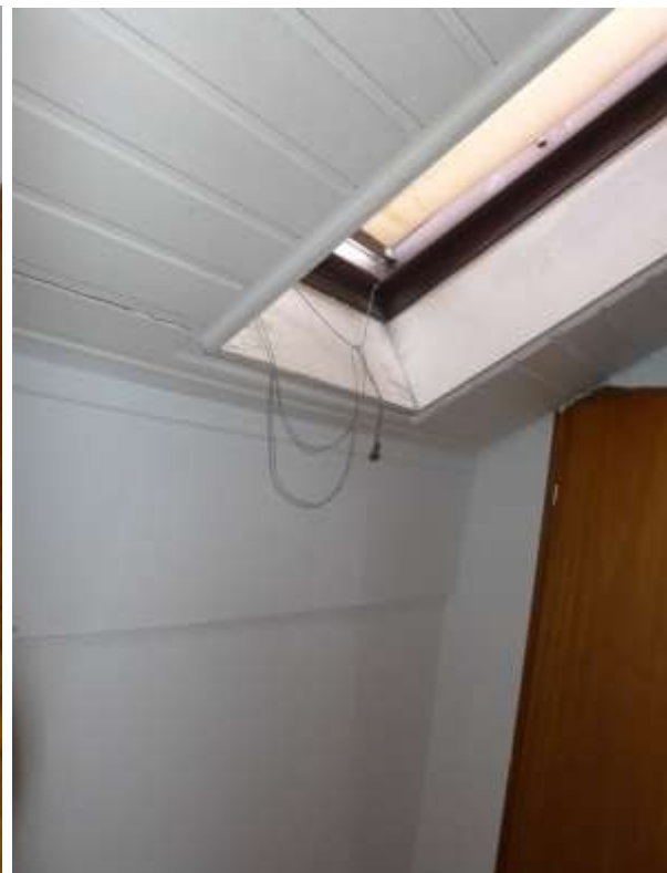
20 b Holzvertäfelung, schadhaftes Dachfenster
