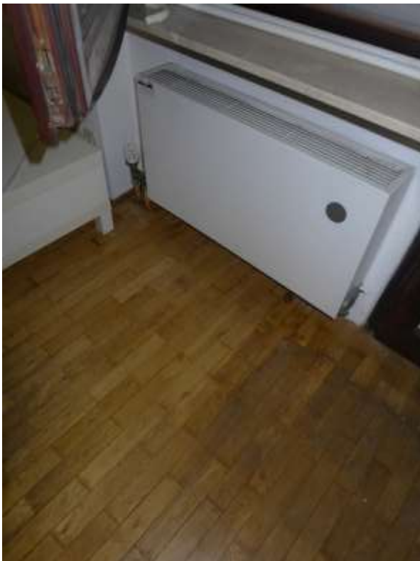
22 a Heizkörper DG
