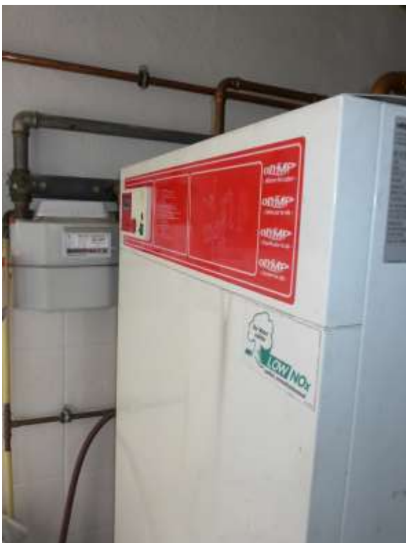
12 Heizung im 2. OG
