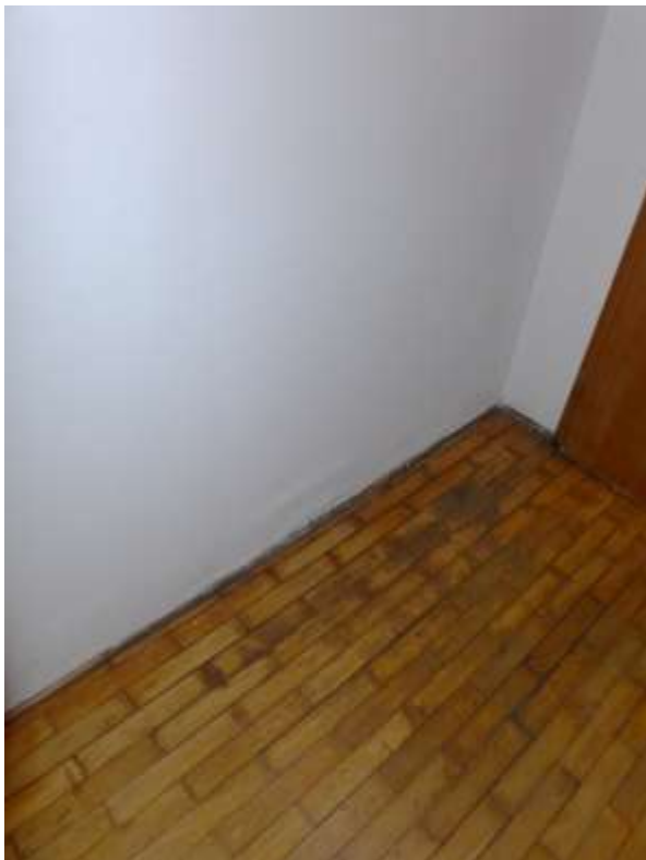
20 a schadhafter Boden
