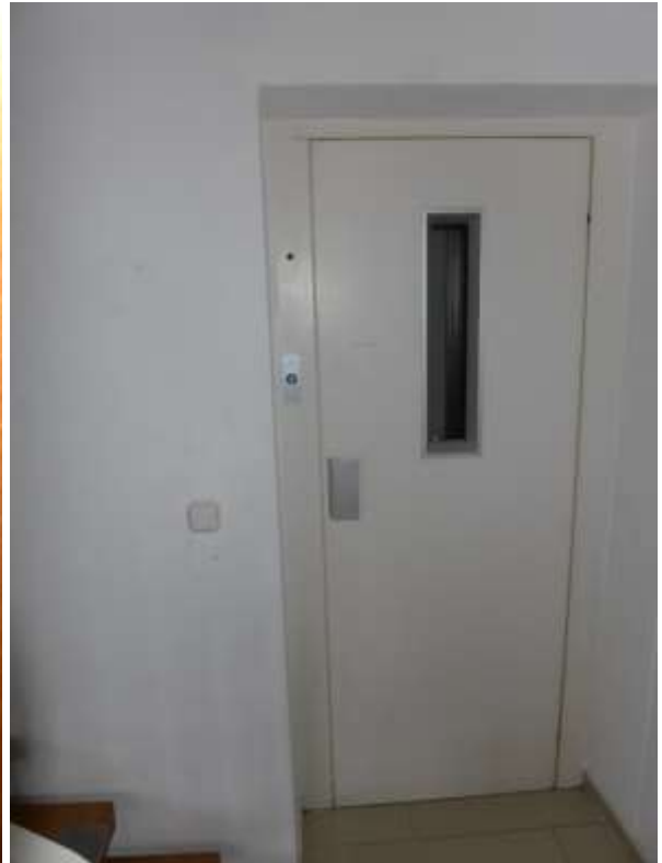
25 b Aufzug (außer Betrieb) in Whg. Nr. 3
