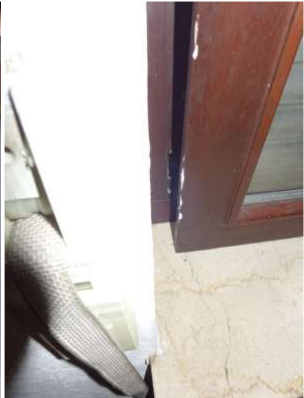
19 b schadhaftes Fenster und Rollladen
