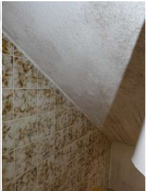
22 b Badezimmer DG, Schimmelbildung
