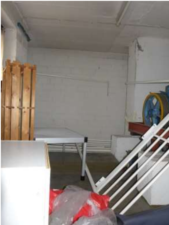
21 a Aufzugsraum DG
