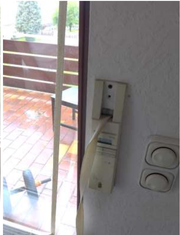
13 b defektes Rollladengurt
