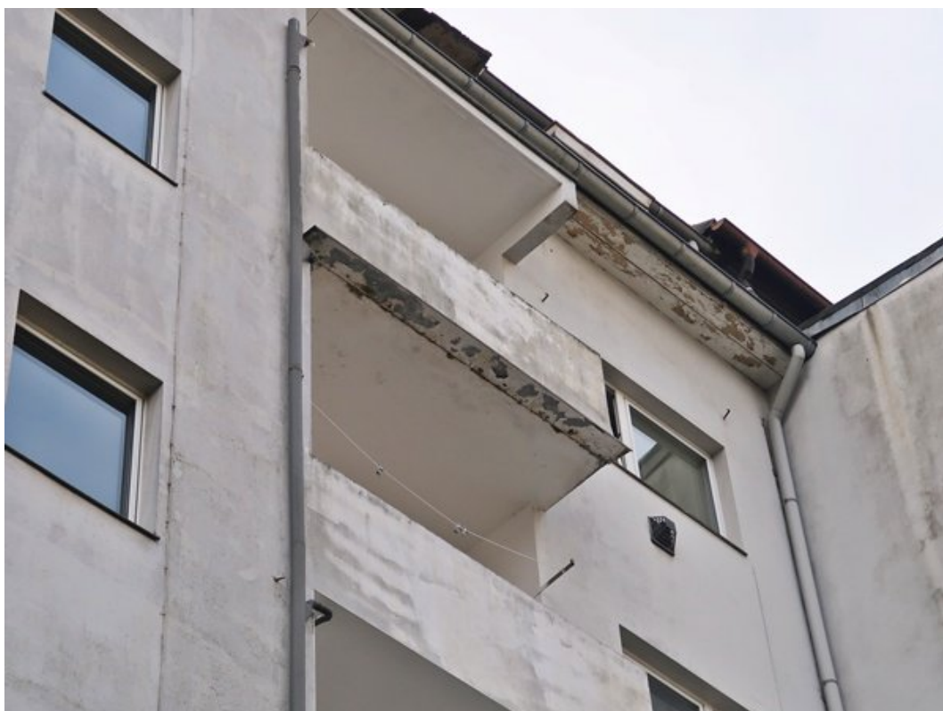
Schäden an der unterseitigen Traufbekleidung
