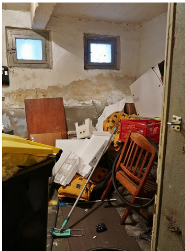
Kellerraum mit Sperrmüllablagerungen
