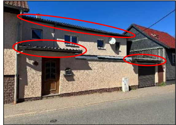
Straßenansicht - Anbau sowie Eingangsbereich und Garage mit Asbestdächern
