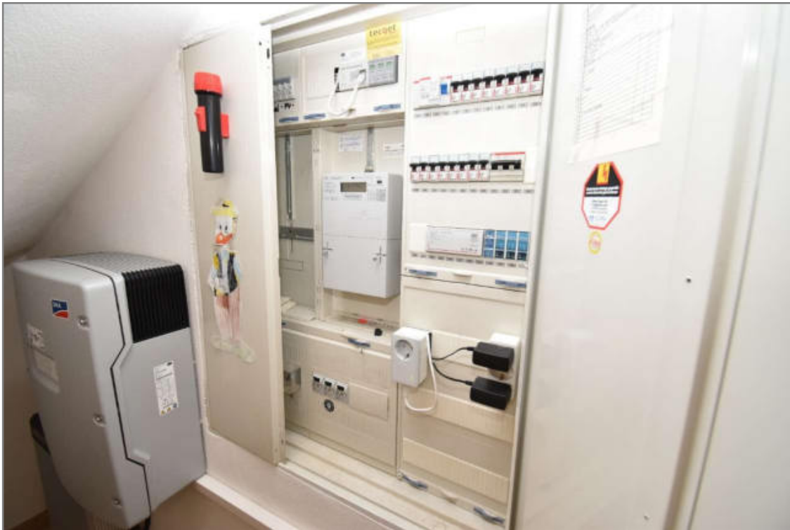
Kellergeschoss, Zähler-/Sicherungskasten und Wechselrichter am Treppenpodest
