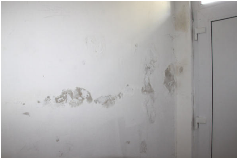
Bild 3 Feuchtigkeitsschäden an der Gebäudetrennwand im Eingangsbereich
