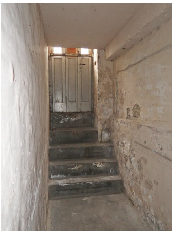
Flur Kellergeschoss mit erheblichen Feuchteschäden
