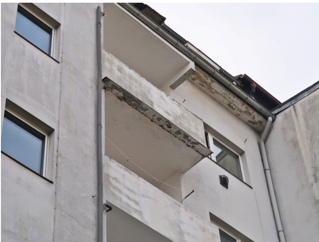
Schäden an der unterseitigen Traufbekleidung
