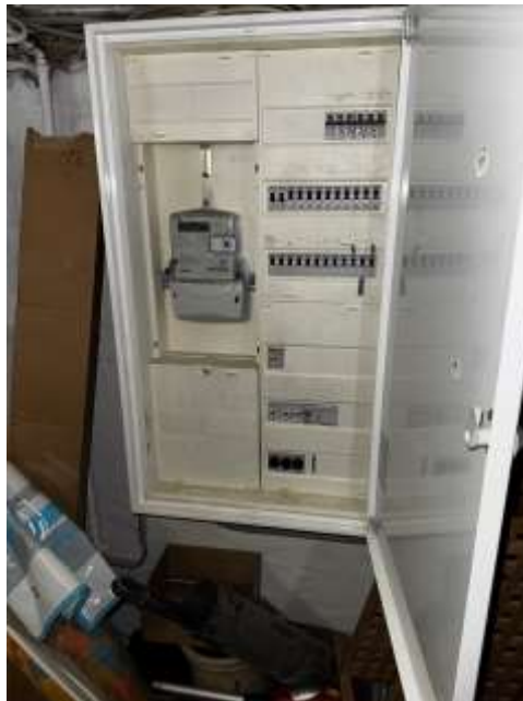
Bild 34: Unterverteilung mit Sicherungsautomaten
