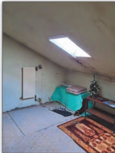
Foto 22 OG: Zimmer mit Wasseranschluss
