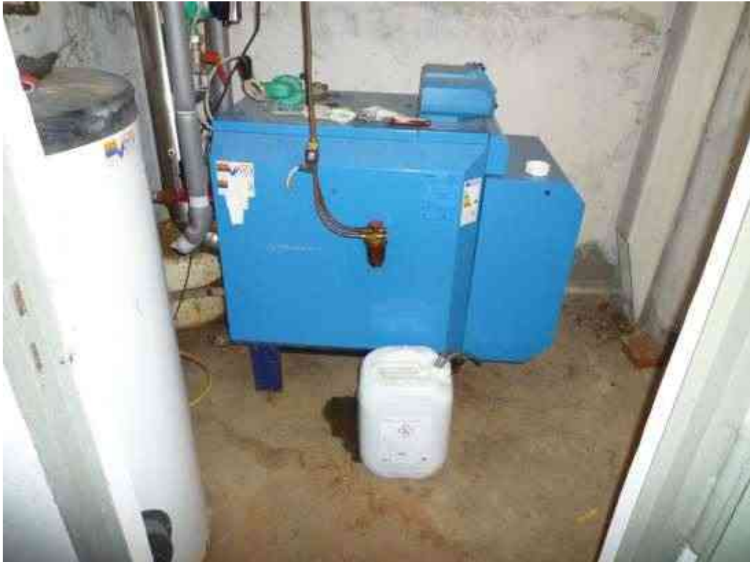
Heizung im Keller / Wohnhaus
