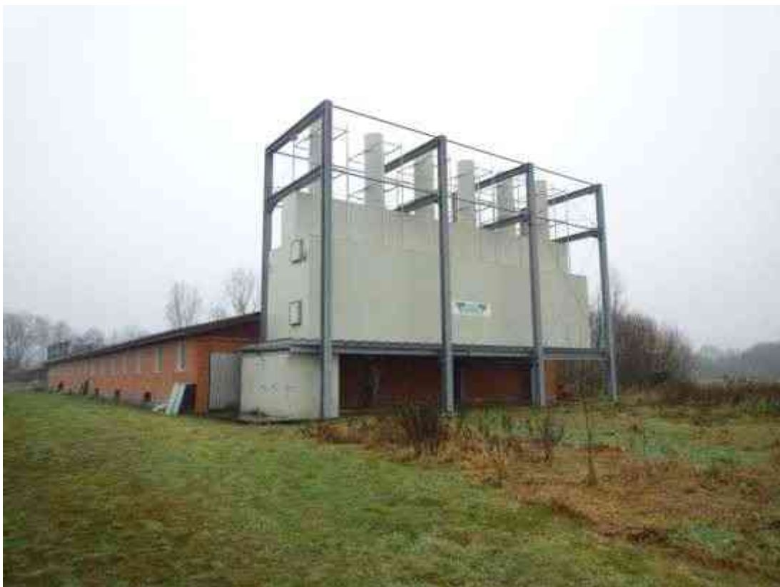
Abluftreinigungsanlage / Schweinemaststall (Baujahr 2008)
