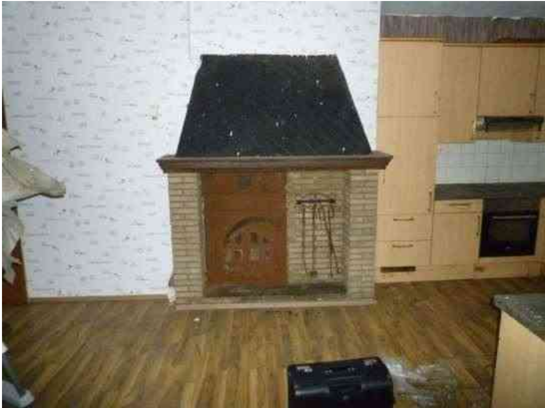
Kamin in der Küche im Erdgeschoss (nicht zugelassen / nutzbar, lt. Eigentümer) / Wohnhaus
