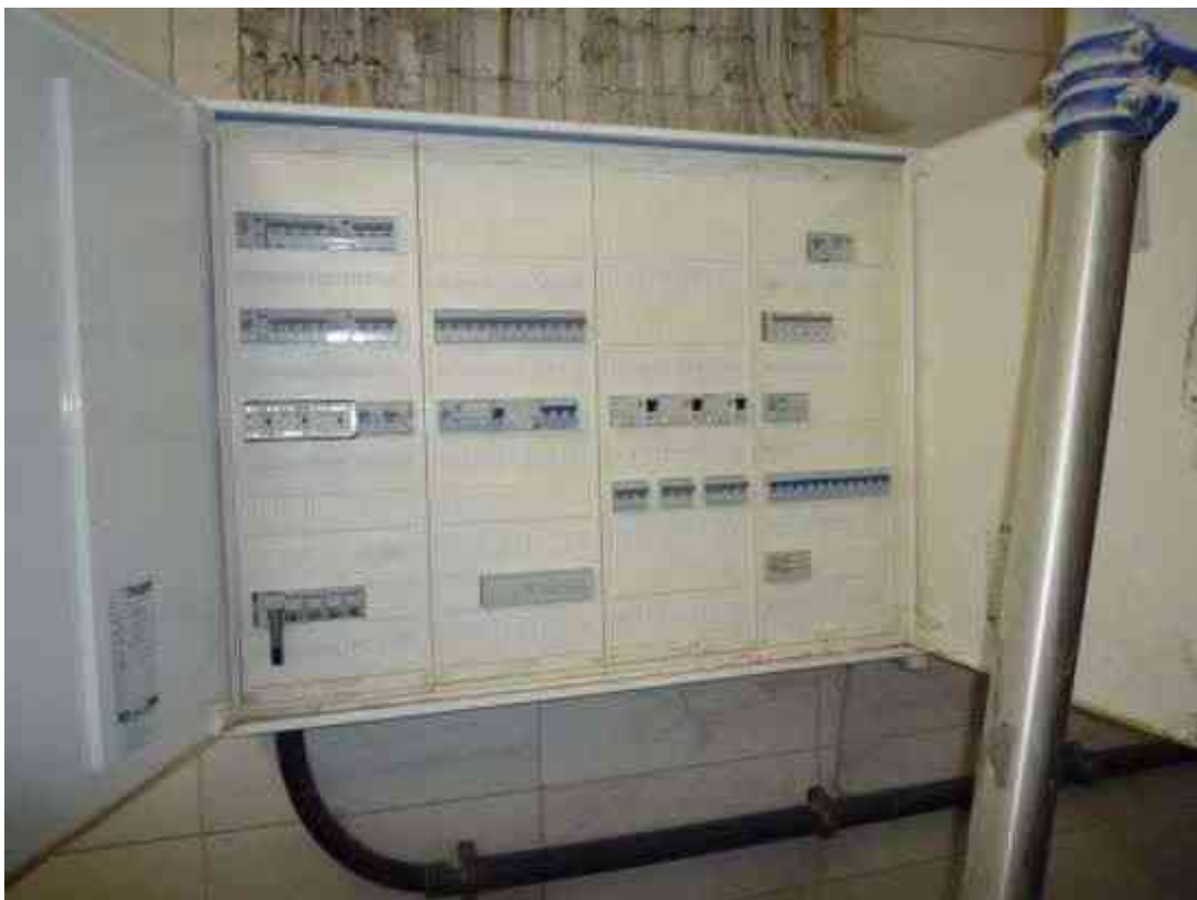
Schweinemaststall (Baujahr 2022) / Stromverteilung
