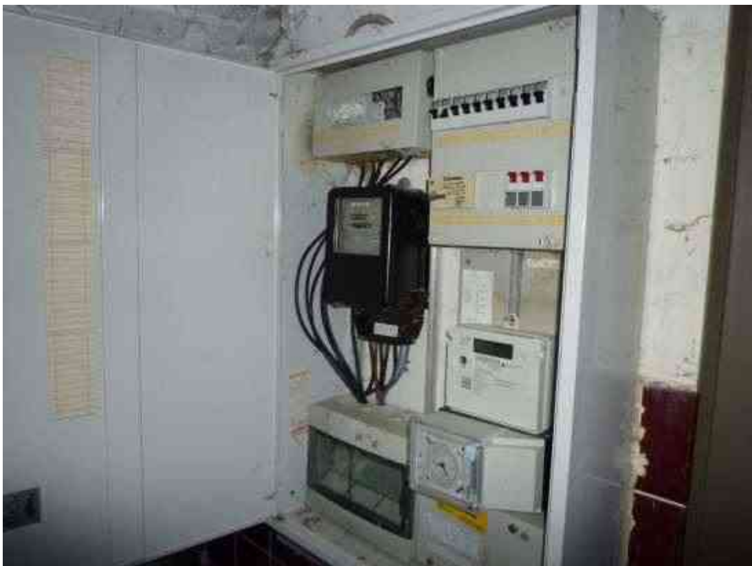
Stromversorgung / -verteilung im Erdgeschoss / Wohnhaus
