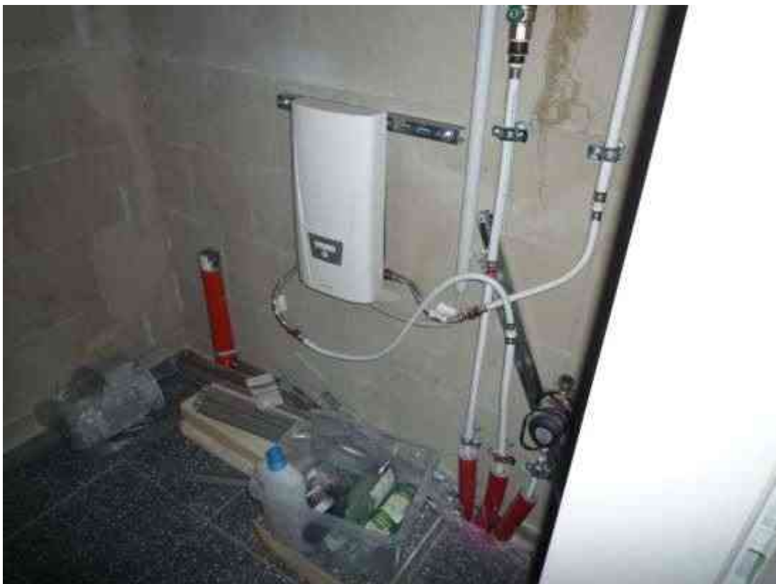
Schweinemaststall (Baujahr 2022) / Durchlauferhitzer für die Hygieneschleuse
