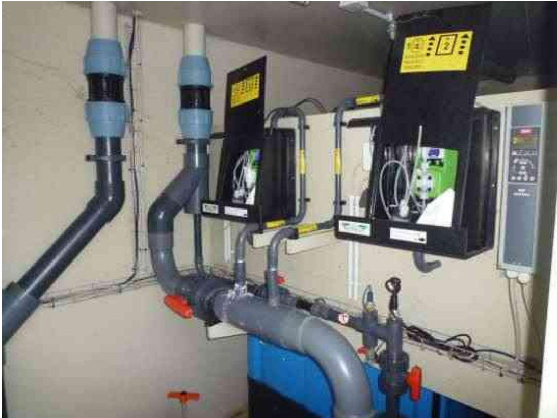
Technik Abluftreinigungsanlage / Schweinemaststall (Baujahr 2008)
