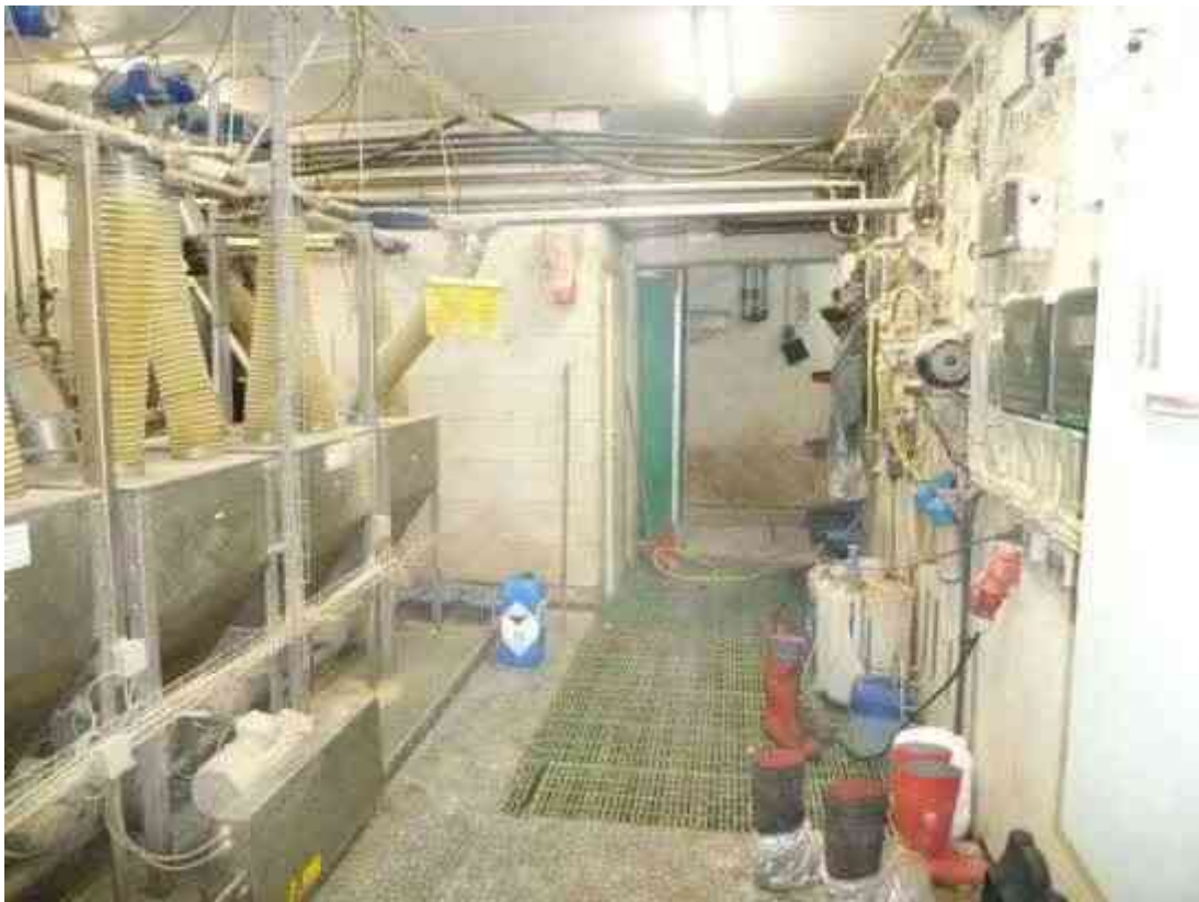
Schweinemaststall (Baujahr 2022) / Fütterungsanlage
